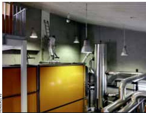
Le lycée Saint-Charles d'Athis-Mons (91) est chauffé au bois depuis 2006.
