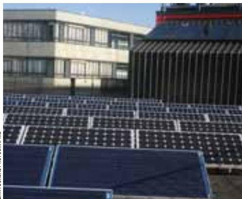
Capteurs sur le toit du lycée Maximilien-Perret, à Alfortville (94).
